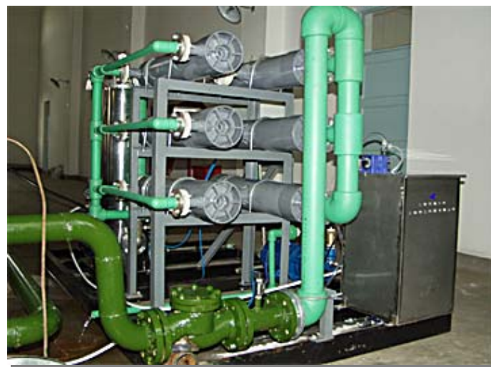
Sistema de desoxigenación de calderas con contactores de membrana, construido por Shen Lan
